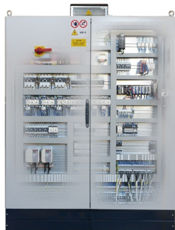
A lato: particolare, con effetto di trasparenza, di un quadro elettrico LM1000 RS che ospita il PLC.
